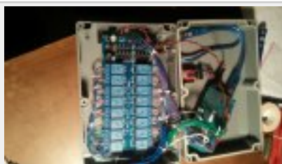
Vue interieure du boîtier de contrôle
