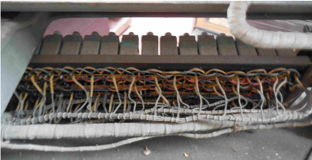
Vue du câblage par derrière
