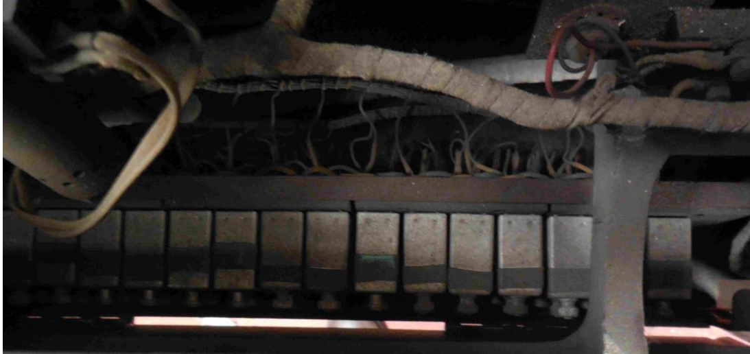
Vue du câblage par dessus
