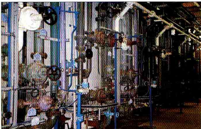
Production de 1 000 t/h d'eau déminéralisée.
