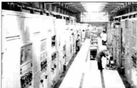
Hall de pompage
