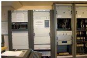
Les armoires de commande
